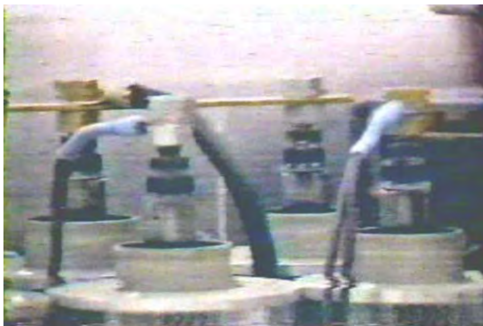
Ignitrons installés sur le " Rouge Motor Charrier "
